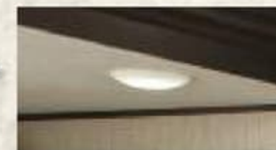
Éclairage à efficacité énergétique DEL
