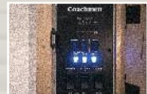
Panneau de contrôle centralisé indiquant les niveaux des réservoirs et de la batterie.
